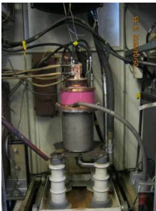
Рис.1 Общий вид лампы ГИ-71А, установленной в модуляторе МГ1.М1
