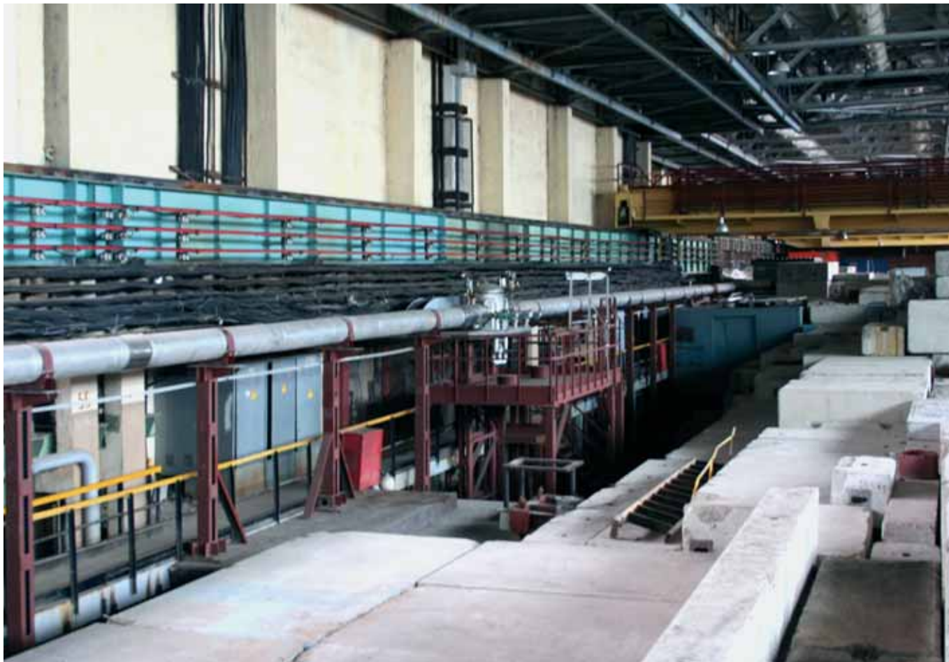
Рис. 9. Криогенный коллектор и распределительный бокс в галерее.
