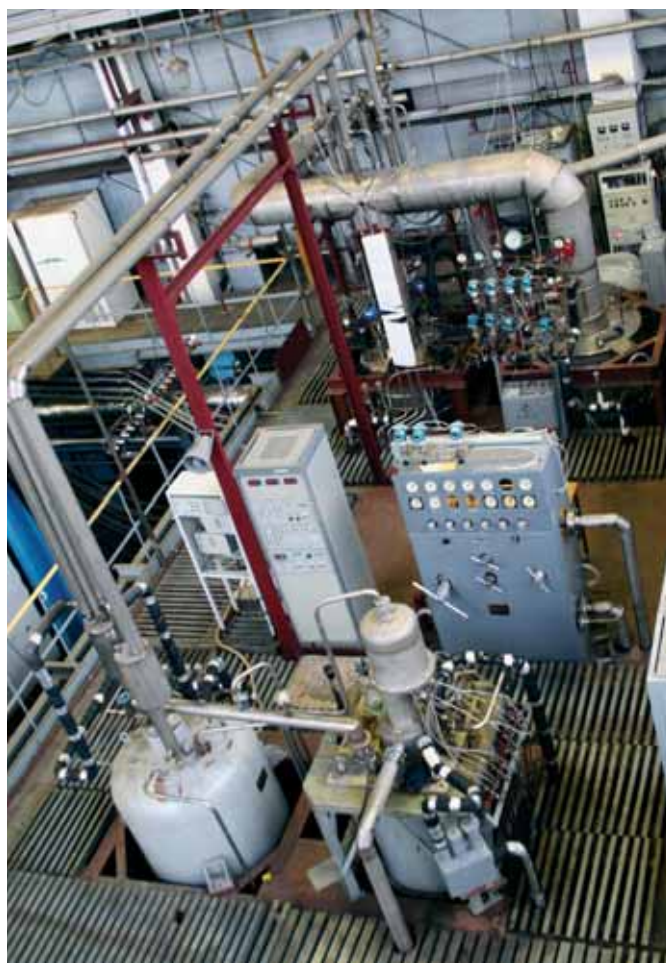
Рис. 6. КГУ-500, ВПО, БВТО и начало криогенного коллектора в ПК1.
